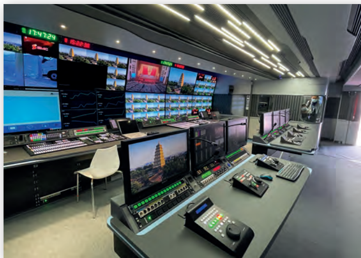
Все рабочие места в ПТС оборудованы средствами служебной связи Riedel
