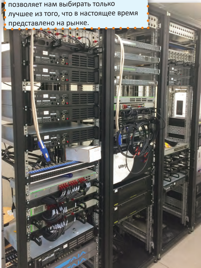
Стойки с технологическим оборудованием комплекса, построенного в Консерватории им. П.И. Чайковского
